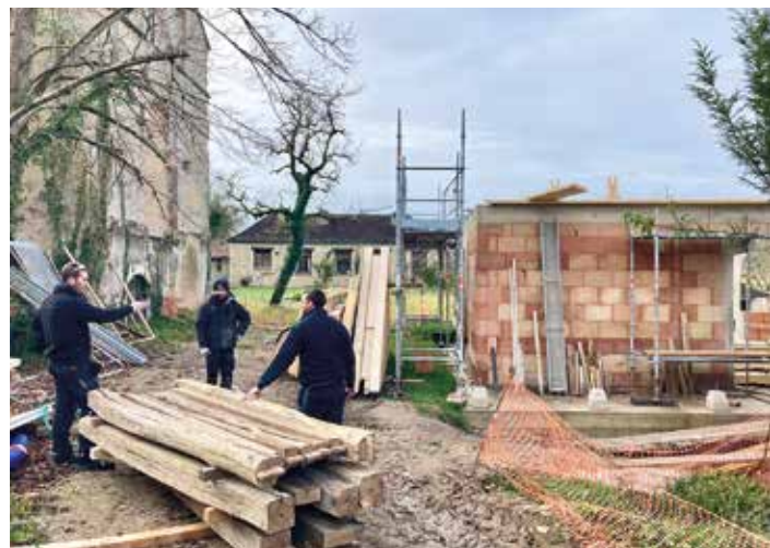
Livraison d'éléments de la charpente du nouveau bâtiment de La Cordelle par les employés de l'entreprise Roy.
